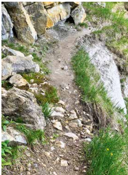
Wegschaden mit Absturzgefahr am «Rot Dossen» Alpnach
