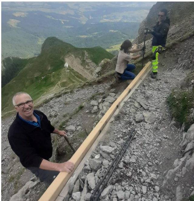
Foto 3 Wegsicherung zwischen Kulm und Klimsenkapelle (unten)
