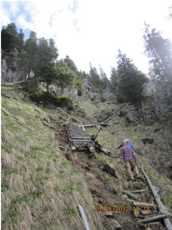
Defekte Treppe bei der Tripolihütte Foto: Mark Waser
